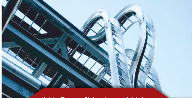
Kablo Taşıyıcı Sistemler ve Kablolama
